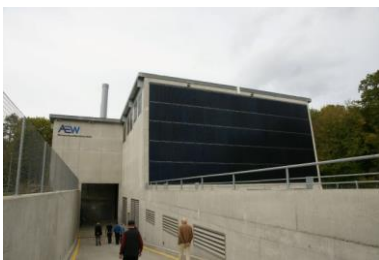
Abbildung 2: Die Photovoltaik-Anlage an der Südfassade, Foto: C. Müller
