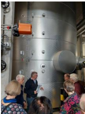
Abbildung 5: Der Fernwärme-Wärmespeicher Foto: M. Gisler
